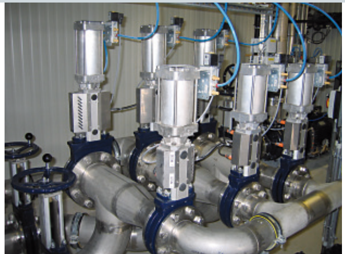
Bild 3: Ventilbatterie für Hygienisierung.
