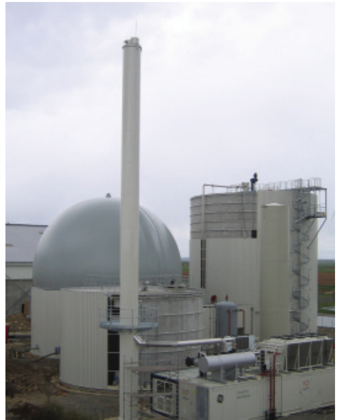
Bild: entec Biogas
